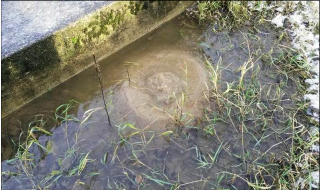
Abb. 9: Qualmwasseraustritt am 6. Dezember 2013
