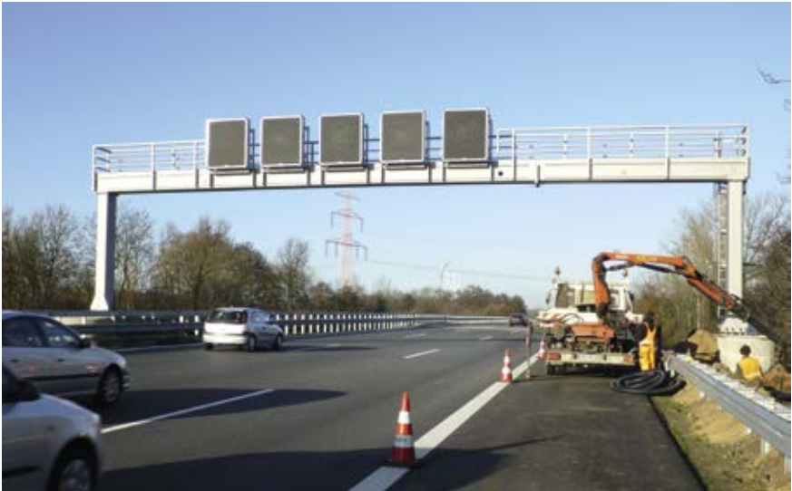
Eine der neuen Verkehrszeichenbrücken
