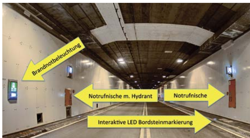
Elbtunnel – eingebaute Notfalleinrichtungen
