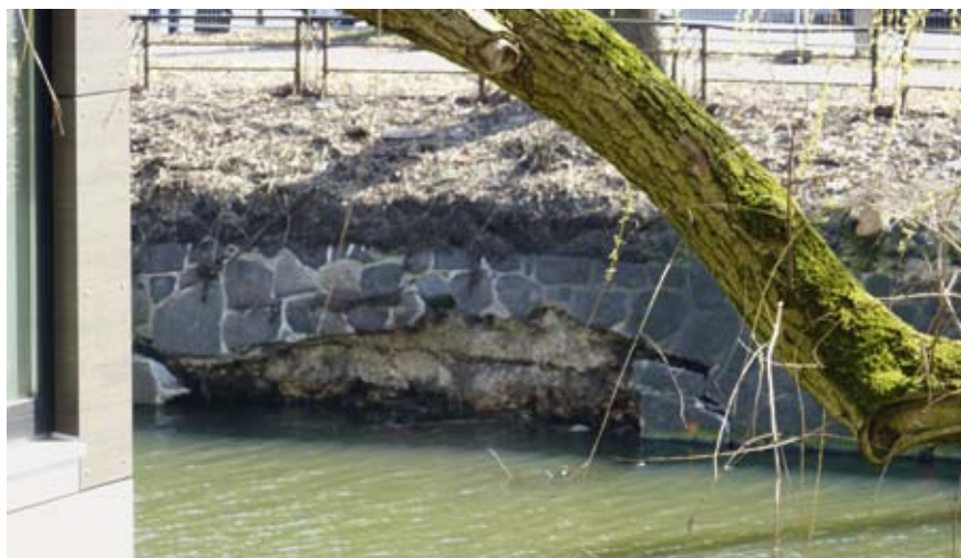
Großflächiger Ausbruch des Natursteinmauerwerkes am Eilbekkanal
